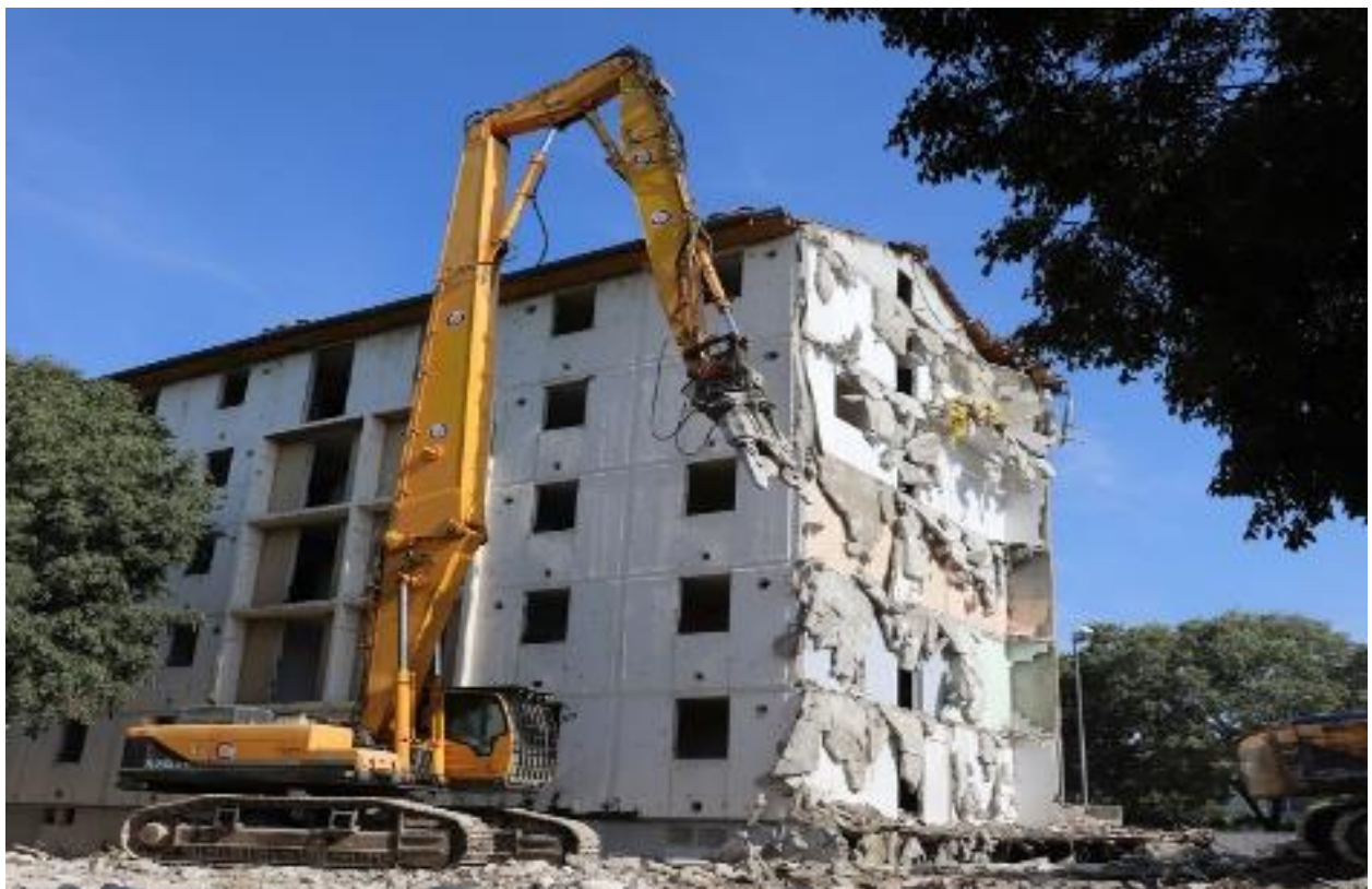
Démolition de la Boule d'Or sur Mas de Mingue – Habitat du Gard
