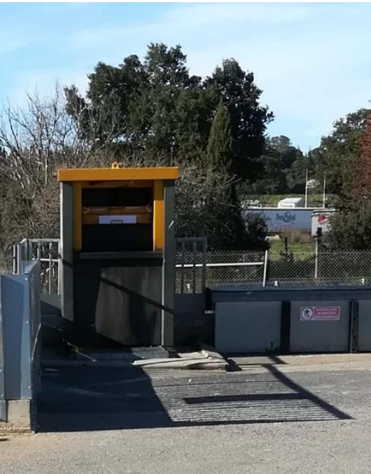
Cuves huiles minérales (avant)
