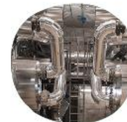
RÉCUPÉRATION CHALEUR FATALE
